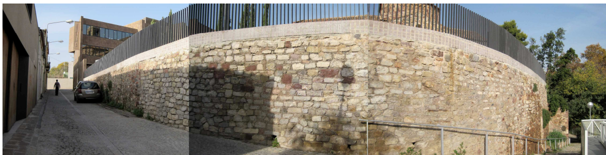
Imatge 23. Vista de la intersecció entre el final del carrer de la Rectoria i el camí que voreja el mur de contenció
