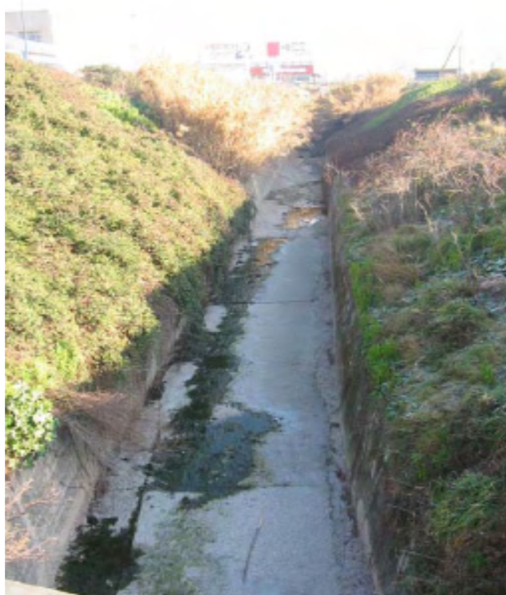
Figura 7. Fotografia on s'observa les característiques de l'endegament del torrent. Font: Pla de viabilitat tècnica i programació econòmica de la integració i millora de la riera de Palau.
