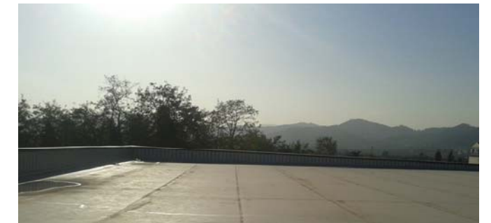
Coberta de lamina de TPO tipus pvc de color clar
